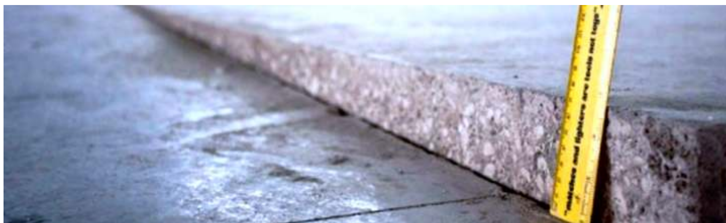
Este tipo de desnível é muito comum em pavimentos de galpões logísticos e industriais.
