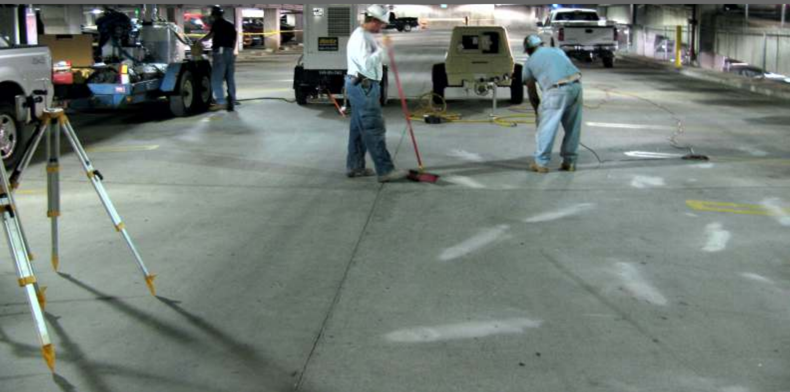
Piso de estacionamento apresentava grandes desníveis. Solução: injeção de Geopolímero.
