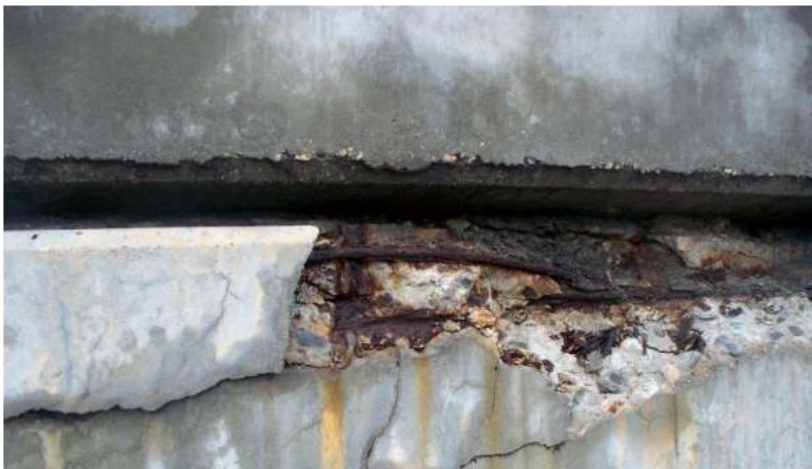
Danos causados por corrosão nas armaduras, podendo levar a estrutura ao colapso.
