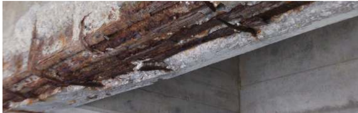
Viga com sérios problemas de corrosão em suas armaduras.
