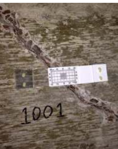
Sistema para monitoramento de trinca não demonstrando nenhuma movimentação.
